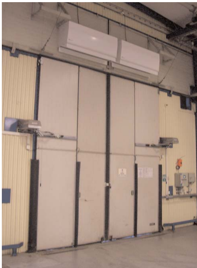
Пример правильного монтажа завес MTV: при открытии ворота складываются вбок, образуя проём ровно на ширину установленных завес. Ворота склада Systemair в Швеции.
